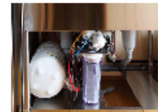
RO純水システム
